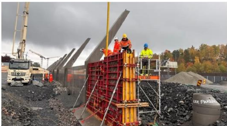
Sigs-betong er brukt i en del av støyskjermen på Ramstadsletta. Foto: Gina Ytteborg/Statens vegvesen
